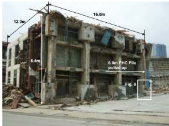
土木学会東日本大震災被害調査団 緊急地震被害調査報告書 江島共済会館
