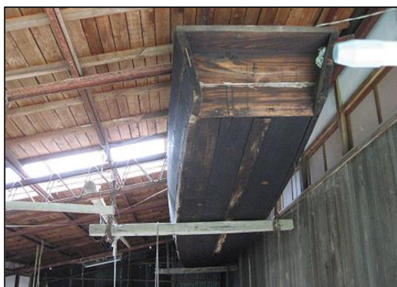
写真－5 水屋に設置された上げ舟
