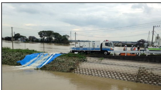
写真-3 茨城県常総市沖新田町の排水ポンプ車
