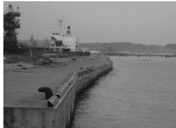
写真-1 液状化被害を受けた小名浜港の岸壁
